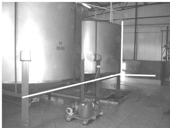
Rys. 6. Osadniki typu Dorra nr III i V w hali podczyszczania ścieków firmy SUPERFISH – strefa prowadzonych badań
